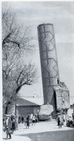
9 Северо-западный минарет. Осадка, уклон. [Контрфорс XIX в.]
